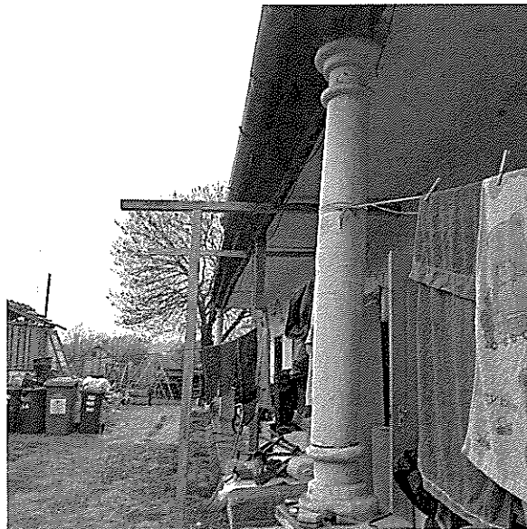
6. fotó: kőanyagú, faragott pillér jelentős tönkremenetele, elmozdulása
