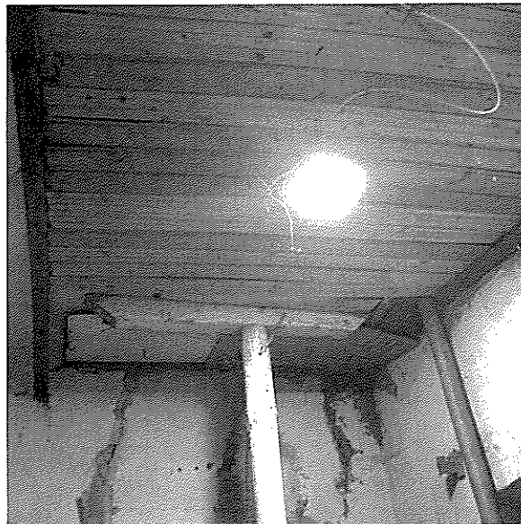
10. fotó: repedezett, rossz állapotú "stukatúr" vakolat aládeszkázása
