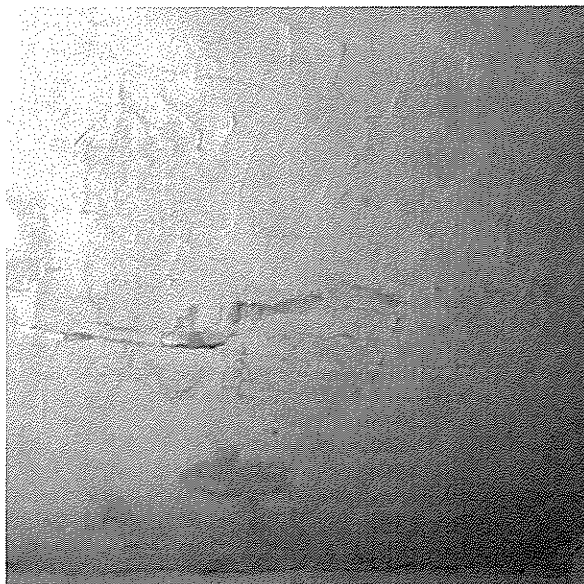
9. fotó: repedezett, rossz állapotú "stukatúr" vakolat
